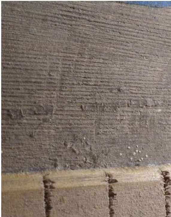
Ilustración 226: Refuerzo de aro estriado y marcas de cepillo de dientes en el aro
